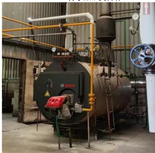
2t/h 蒸汽锅炉
