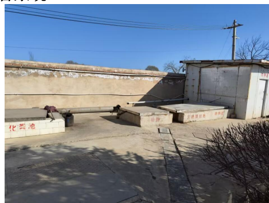
综合污水处理站
