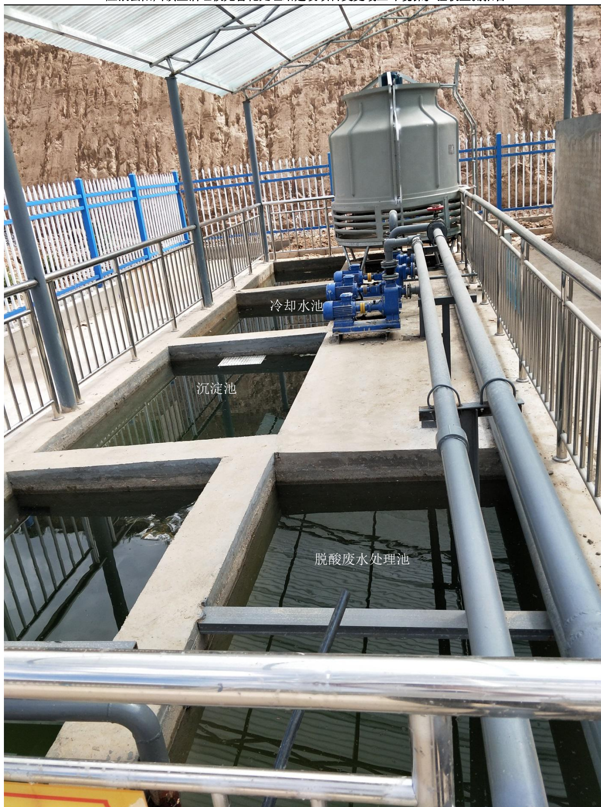
图 4-5 污水处理设施
