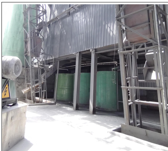
脱硫废水沉淀罐
