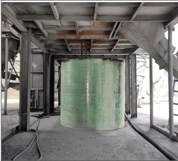
脱硫废水沉淀罐
