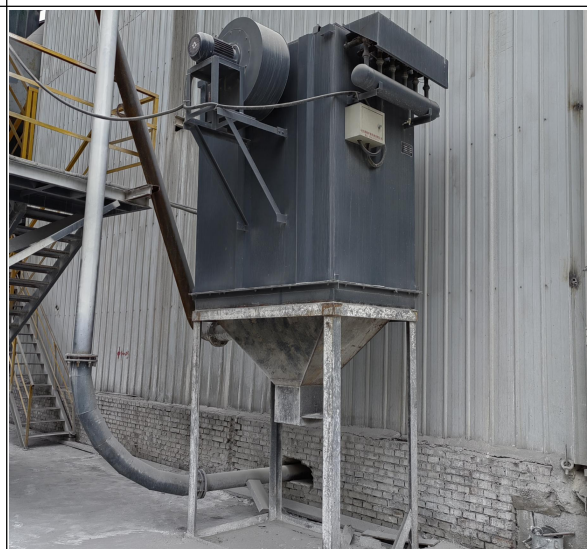
收尘仓卸灰布袋除尘器
